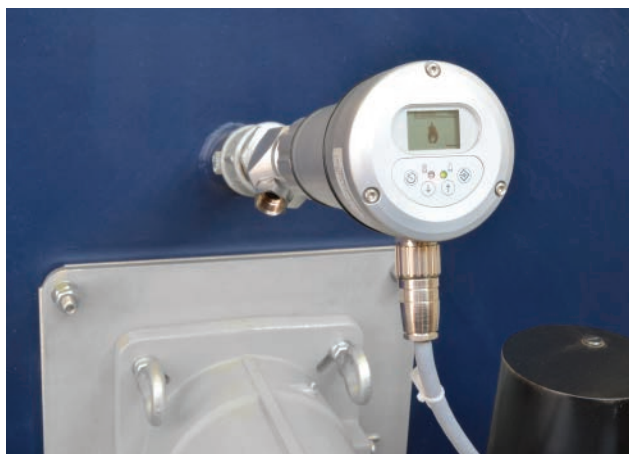
Le contrôleur de flammes LAMTEC F300K en service.
