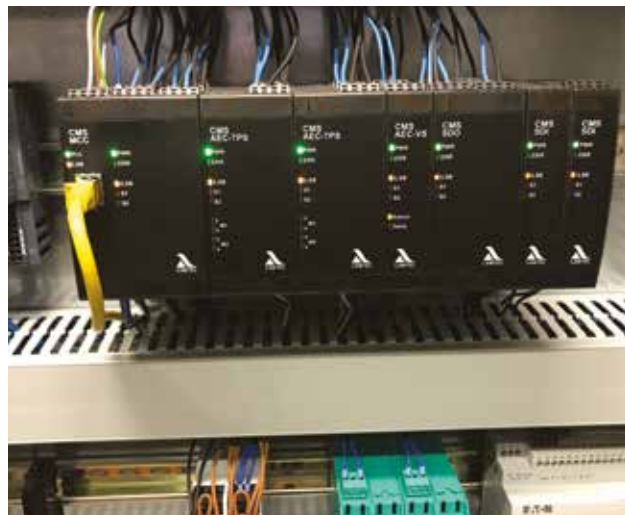
CMS-Module im Schaltschrank verbaut.
