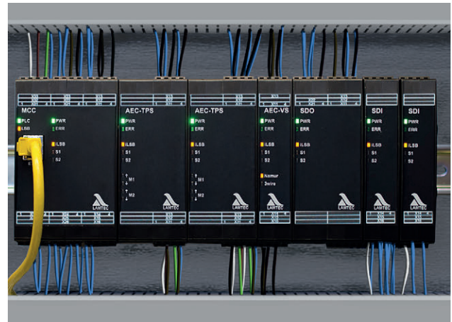
CMS-Module im Schaltschrank verbaut.
