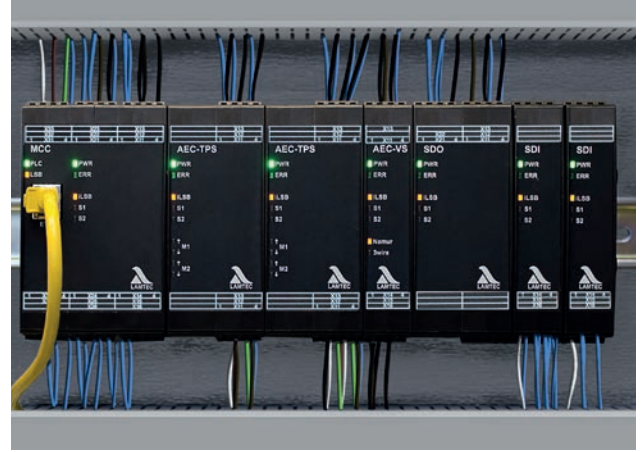
CMS-modülleri kontrol kabininde monte edilmiştir.
