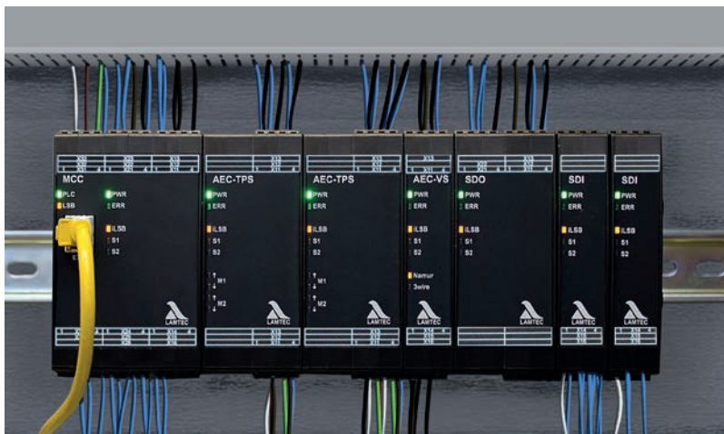
LAMTEC Combustion Management System CMS als Schaltschrankeinbau
