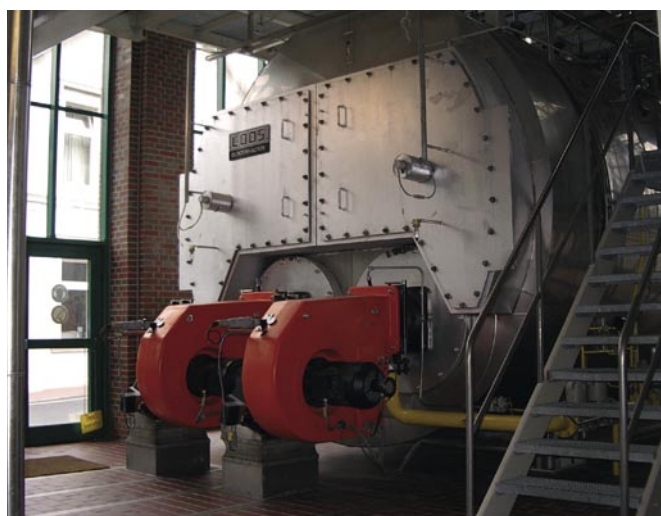
2 x brûleurs Elco Klöckner de 6,8 MW chacun avec régulation du CO/O_2 dans la brasserie Friesisches Brauhaus zu Jever.
