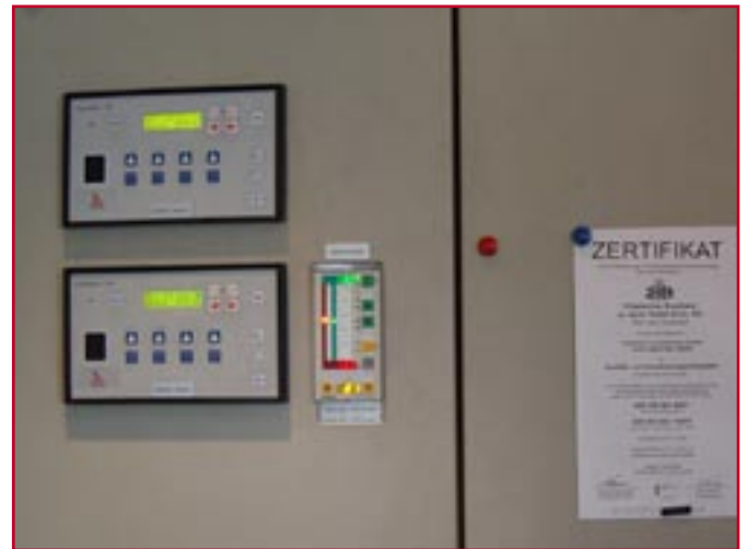
2 x ETAMATIC S elektronische Brennstoff-/Luftverbundregelung mit integrierter Drehzahlregelung des Verbrennungsluftgebläses und CO/O 2 -Regelung
